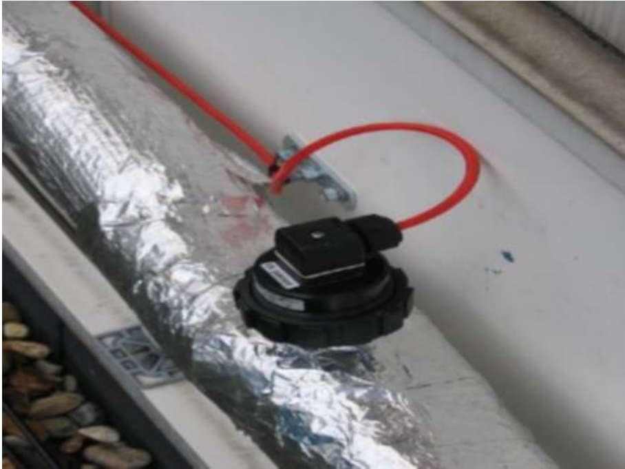
Afbeelding 3. Debietmeter dak 15 (boven) en dak 17 (onder)
